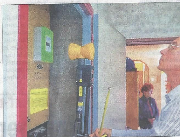
Un technicien en train d'installer l'appareil de mesure à 20 centimètres du compteur Linky. « C'est la limite pour relever les données », explique-t-il. Photo Le DL
